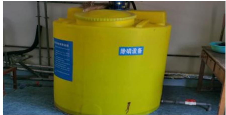
图 3.4-6 污水站除磷设备
