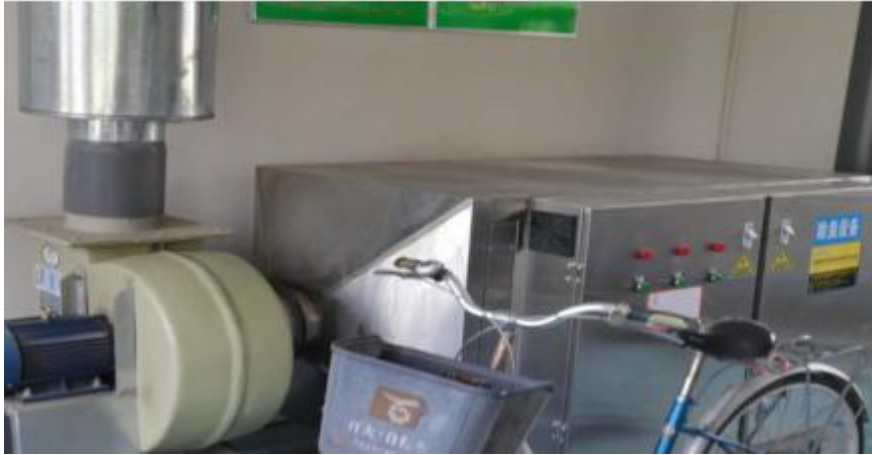
图 3.4-3 污水站除臭设备
