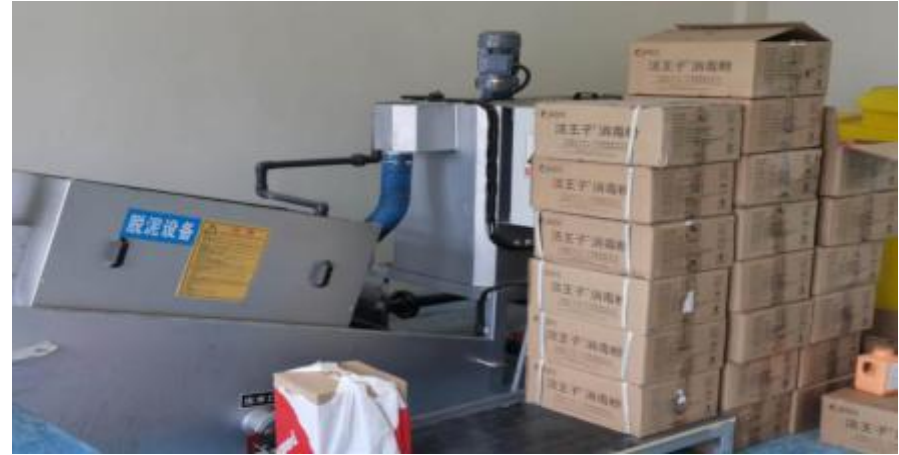
图 3.4-4 污水站脱泥设备
